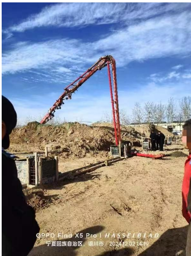
事故现场照片 1-3
