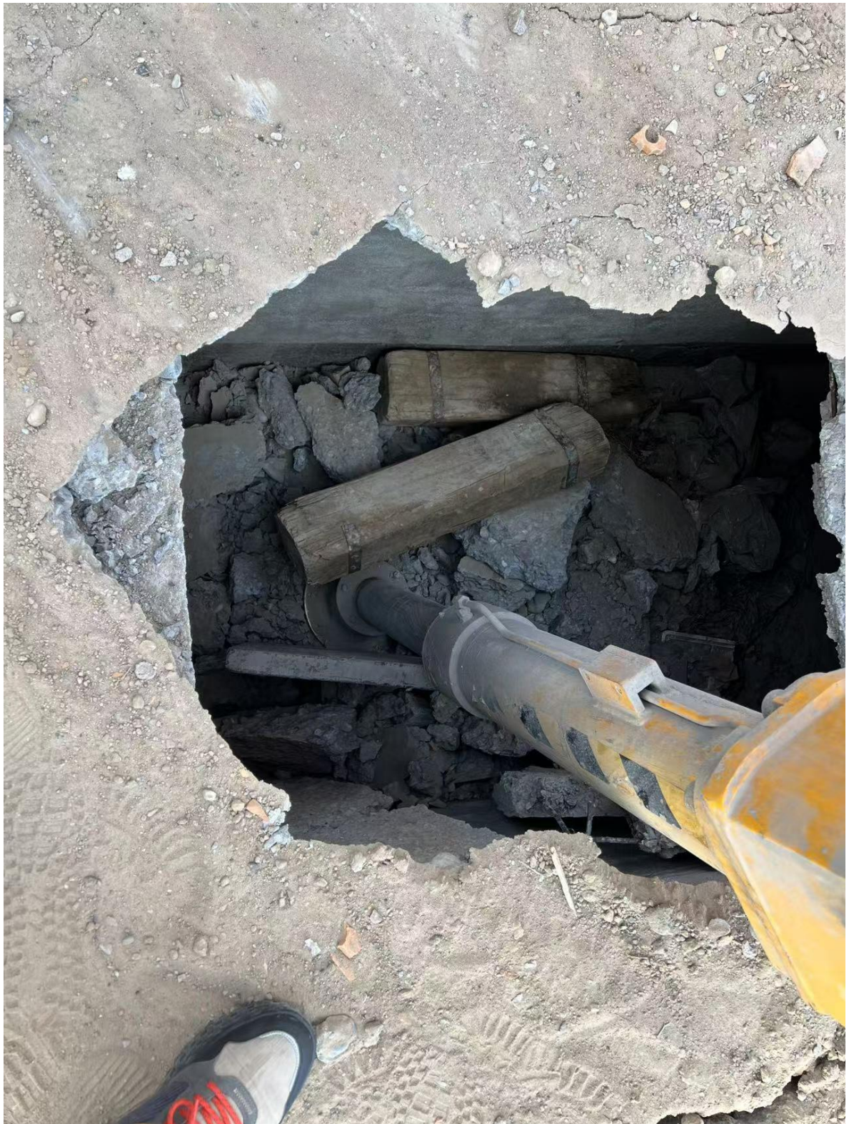
事故现场照片 1-2
