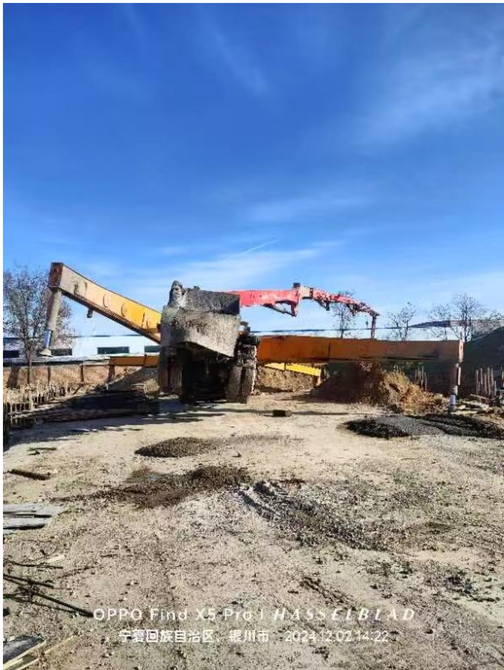
事故现场照片 1-1
